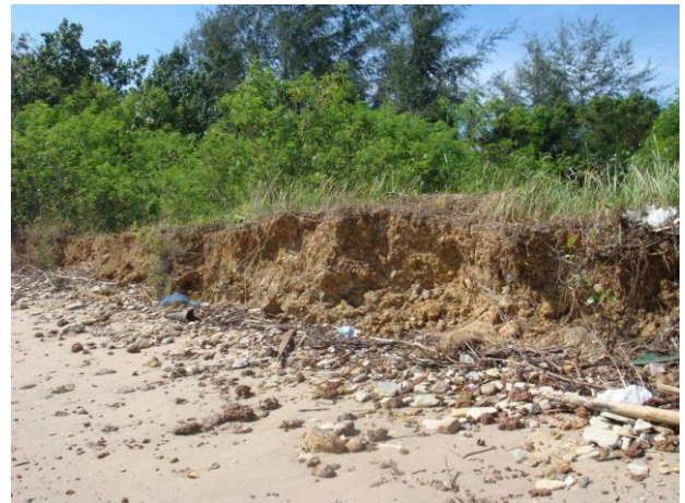
รูปที่ 4-5 การกัดเซาะชายหาดด้านที่ติดทะเล หมู่ที่ 2 บ้านคลองประสงค์
